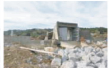
▲田老地区の堤防崩壊現場
